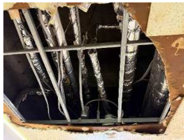
7階 スプリンクラー破損
