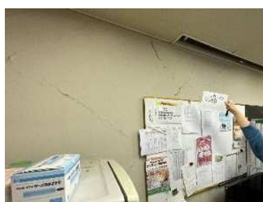
3階 内壁クラック
