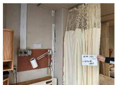
7階 柱躯体損傷
