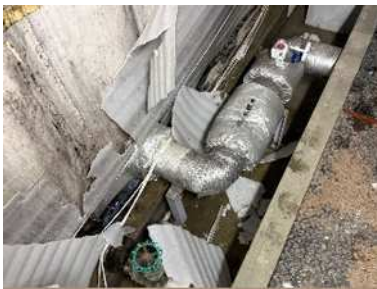
PH階 高置タンク損傷
