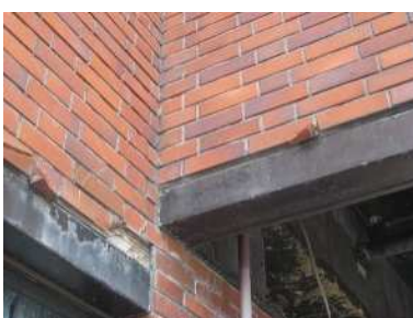
外壁タイル落下
