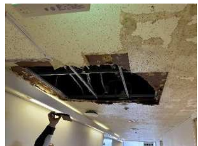
6階 漏水による天井落下
