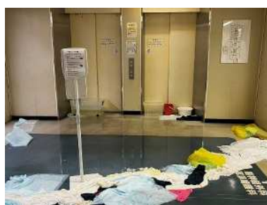
浸水によるエレベーター故障
